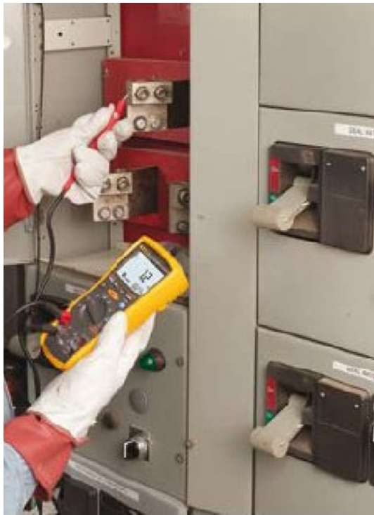
FIGURA 1.2. Comprovació de tensió amb el multímetre digital
