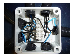
Caixa de derivació
