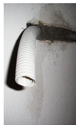
Tub corrugat encastat a la paret.
