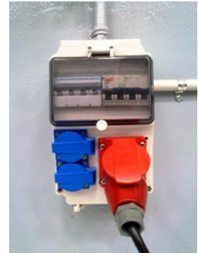
Proteccions amb preses de corrent a peu de màquina en una indústria.
