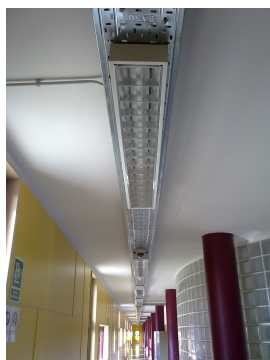
Safates metàl·liques perforades amb enllumenat adossat a la part inferior de la safata
