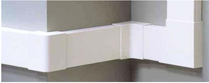
FIGURA 2.1. Instal·lació elèctrica amb canal motllura
