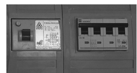
Quadre elèctric d'electrificació bàsic
