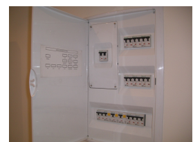
Quadre elèctric d'electrificació elevada
