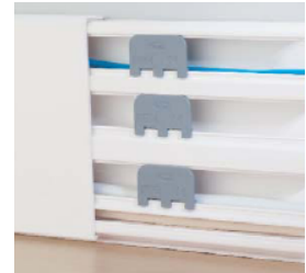
Sòcol UNEX. Els cables elèctrics han d'anar a la ranura més elevada del terra.
