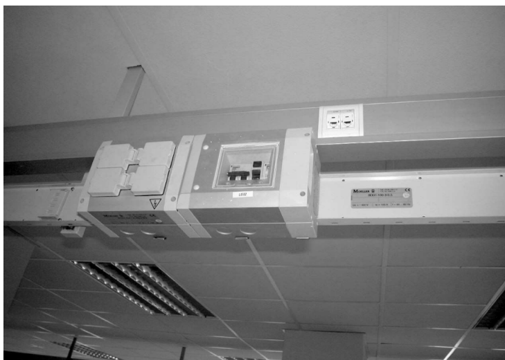
FIGURA 2.10. Exemple d'instal·lació amb canalització elèctrica prefabricada
