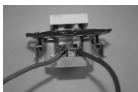
Un cable mal posat en un mecanisme
