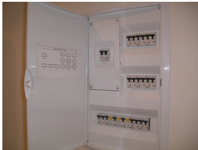
FIGURA 2.13. Caixa de protecció amb electrificació elevada
