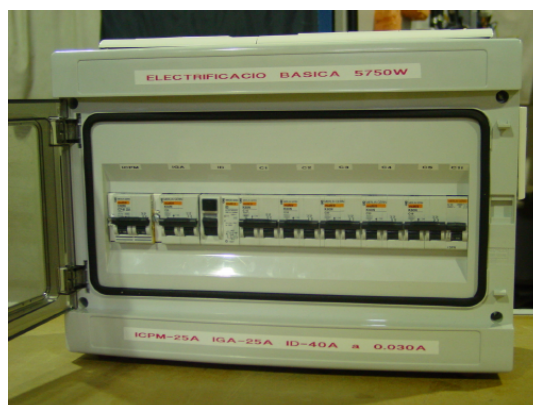
FIGURA 1.1. Quadre general de comandament i protecció
