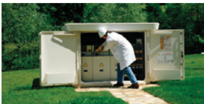
FIGURA 2.1. Centre de transformació
